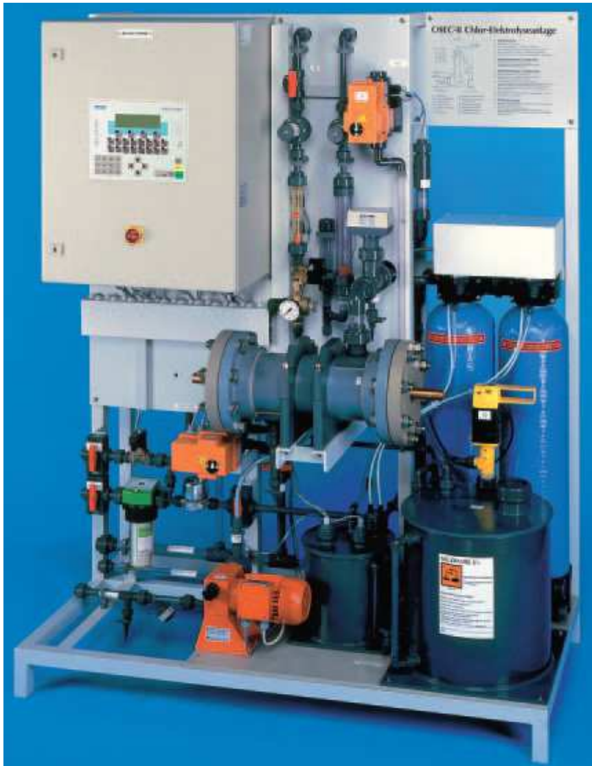
Figure 3. Poste de production d'hypochlorite de sodium par électrolyse OSEC-B™.
